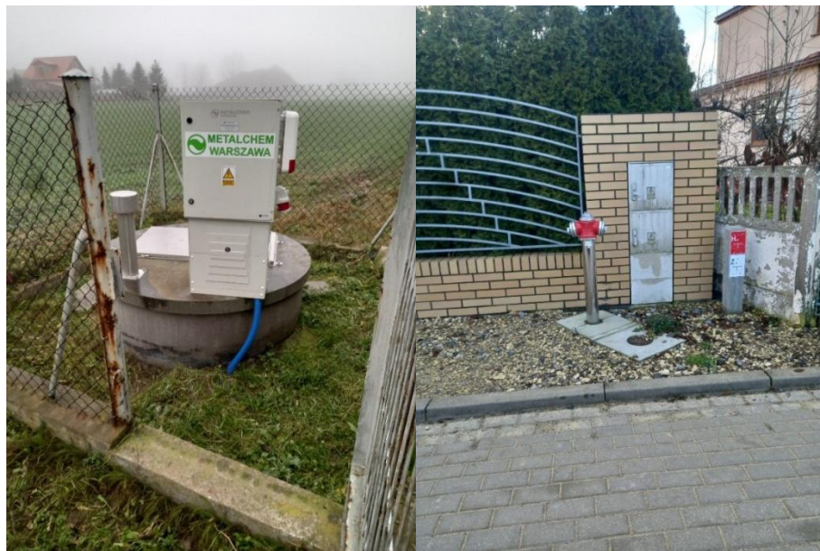
Zdjęcie 16.1.3 i 16.1.4. Przepompownia ścieków i hydrant w ramach poprawy infrastruktury wodno-kanalizacyjnej na terenie gminy Lubochnia
